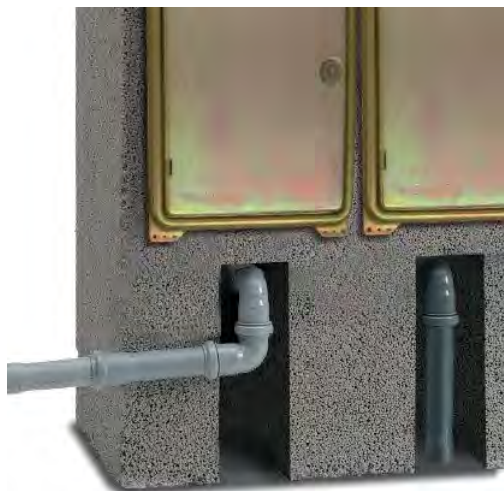
Fig. 7-1: Écoulement du condensat
